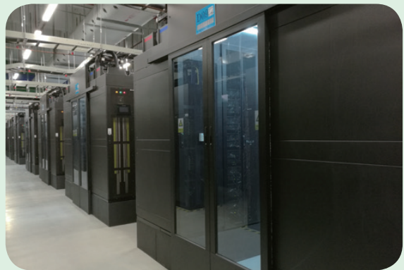
大型集中式实验室能效大幅提高
